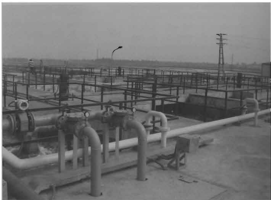
Trạm xử lý nước thải tập trung khu công nghiệp Phố Nối A - Hưng Yên
