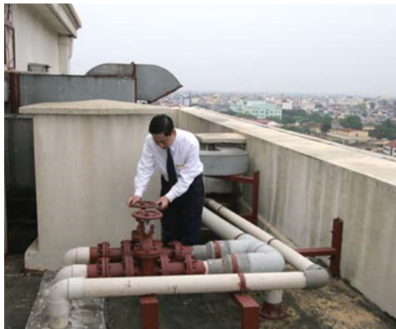
Hình 2.6. Tuần tra, kiểm soát thiết bị an ninh, an toàn
