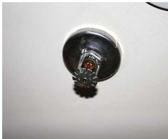
Hình 2.7. Thiết bị báo cháy
