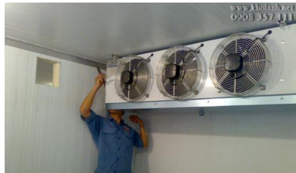
Hình 2.15. Hệ thống quạt của kho lạnh
