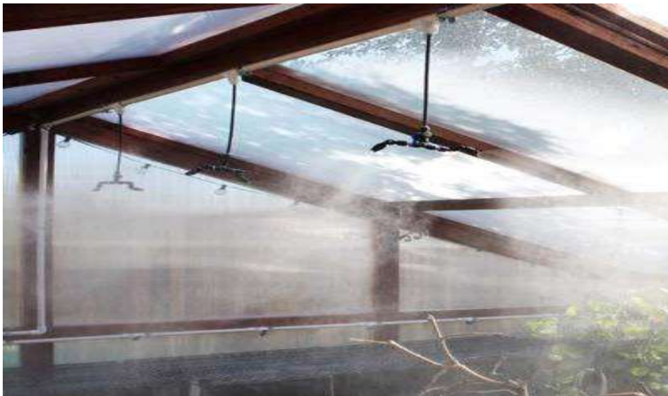
Hình: 1.1.22: Hệ thống phun sương
