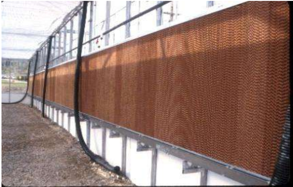
Hình: 1.1.21: Đệm thoát hơi nước làm mát
