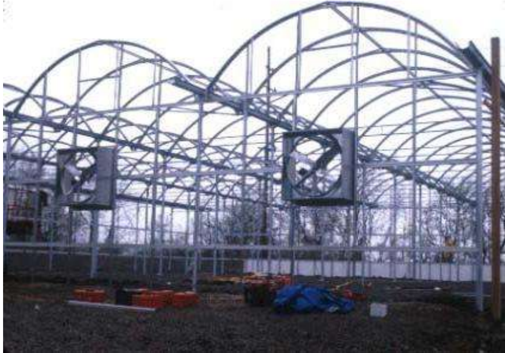
Hình: 1.1.20: Hệ thống thông gió bằng quạt
