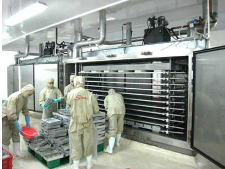
Hình 2.4. Tủ đông tiếp xúc
